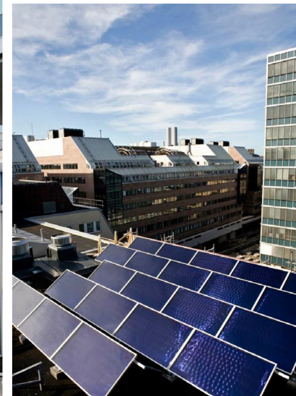
På taket till fastigheten har 100 m 2 solfångare från S-solar monterats. Varje år kommer anläggningen att generera 45 000 kWh energi. Livslängden på anläggningen är beräknad till minst 25 år.
