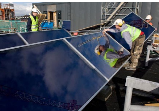
Tack vare ett sinnrikt fästsystem går det snabbt att montera solfångarna. Hela installationen gjordes i detta fall på drygt två dagar av två man.
